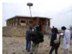
手づくり省エネ住宅 NHKにも取り上げられた 手づくり省エネ住宅を学生 と共同で施工
