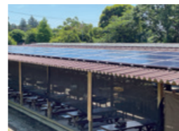
太陽光パネル
